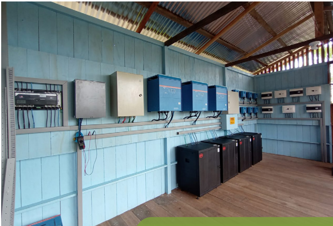
Foto: Conversores dos painéis solares instalados na comunidade São Raimundo
